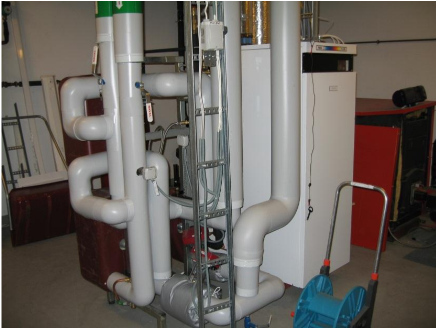
Varmesentral i Havly borettslag.
