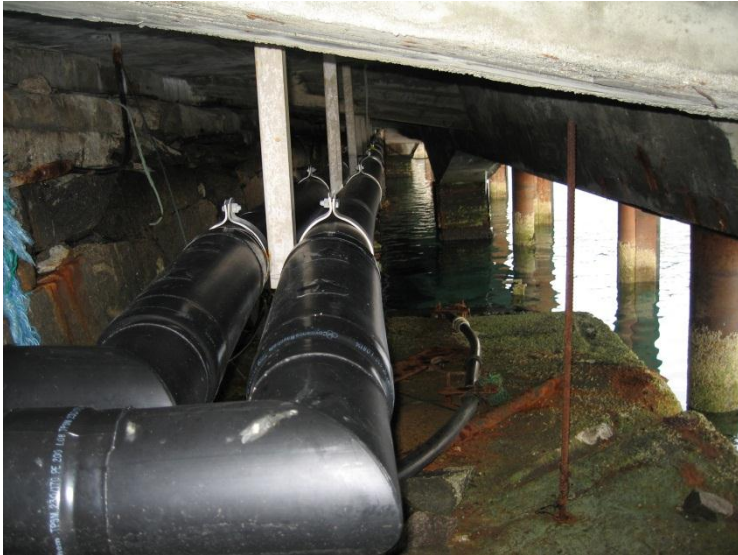
Varmepumpeledning under brygga.
